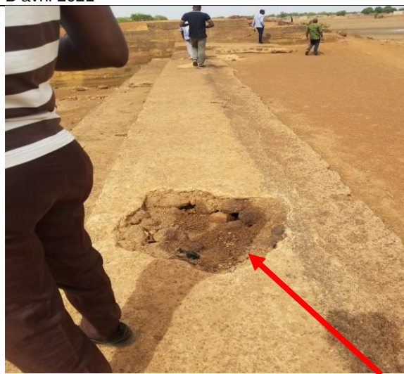
Photo 11 : Dégradation sur le béton du déversoir, CAFI-B avril 2021
