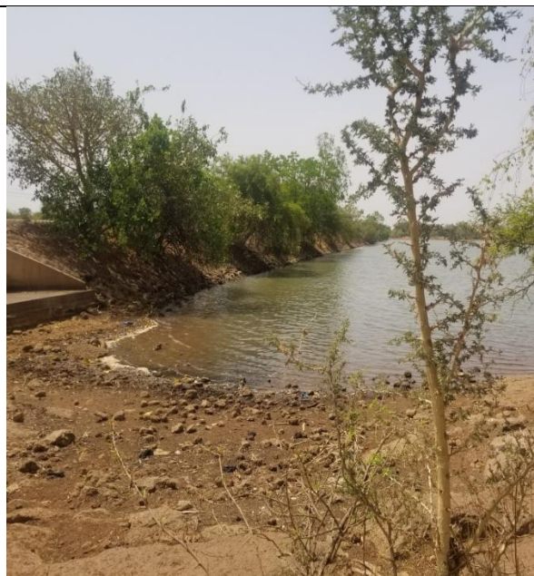
Photo 2 : Vue sur le talus amont de la digue du barrage colonisé par les arbustes, CAFI-B avril 2021
