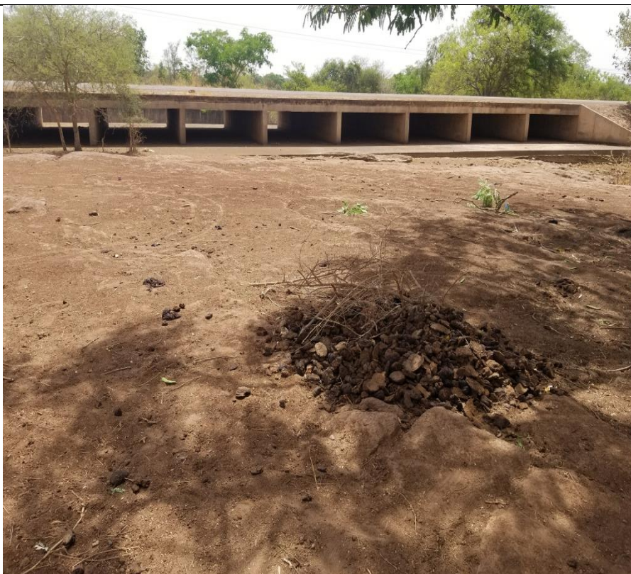
Photo 3 : Seuil déversant couplé avec un dalot de 8x4x1,5, CAFI-B avril 2021
