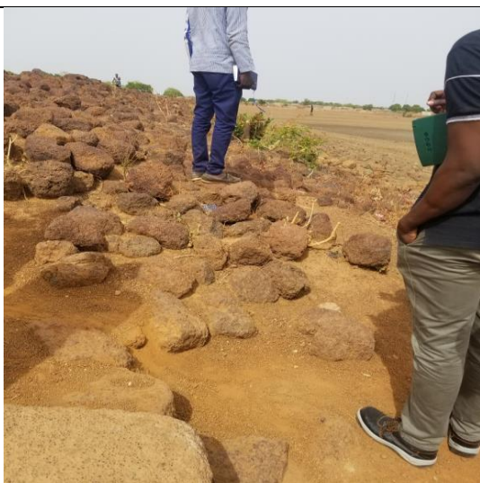
Photo 10 : Perré amont dégradé, CAFI-B avril 2021
